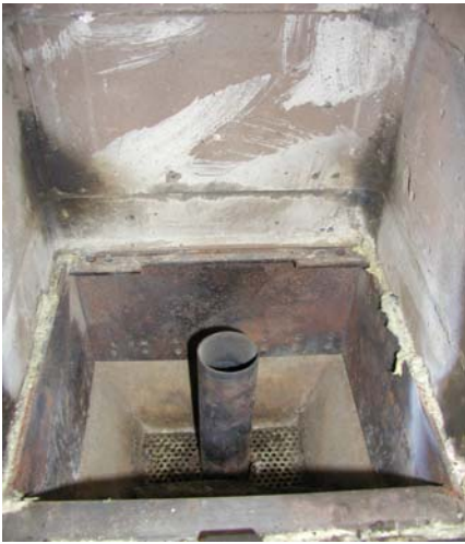
Pellettisäiliön teräskehys ja jälkipolttoarina (reikälevy)
